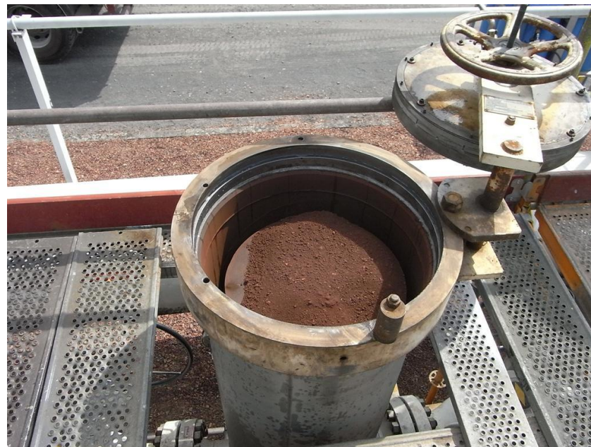
Filtre après cleaning run
