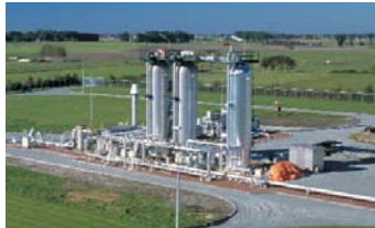
Ondergrondse aardgasopslag: Loenhout
